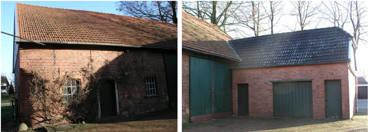
Abb. 4 Stalltrakt (links) und Garagenteil (rechts) der zum Abriss vorgesehenen Scheune von West bzw. Nord-West
