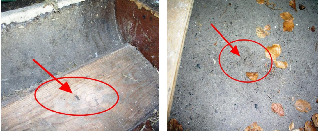
Abb. 18 Kotfundstellen 6 & 7 Stalltrakt der Abbruchscheune: Vermutlich Hinterlassenschaften bei Ein- oder Ausflügen der o. g. Fledermausarten
